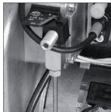
Рис. 16: Регулировка подпорной шайбы горелки
